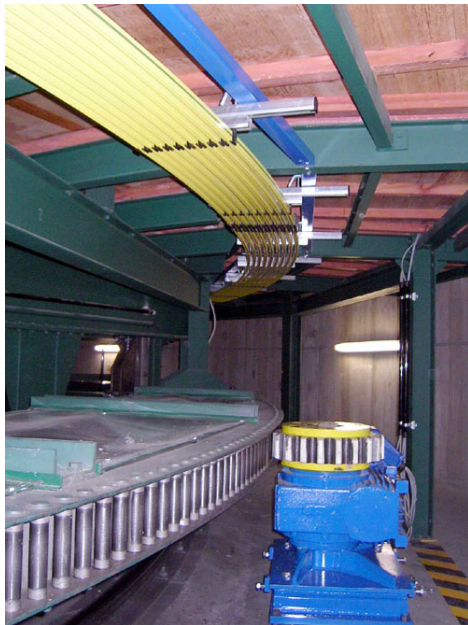
BU: Schleifleitungssystem zur Versorgung und Steuerung der einzelnen Ringbereiche der Drehbühne.
